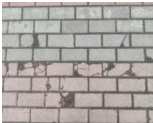
(Рисунок 2, напольная плитка, поврежденная морозом)
